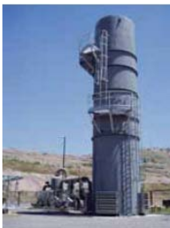
図 14 ゴミ埋め立て場のメタンガス燃焼プラント（出所：三井物産ホームページ）
