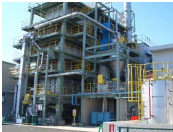
図 4、バイオマスボイラー工場【出典:辻製油 HP】
